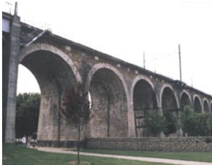
Wiadukt na linii Le Pecq – Saint Germain, który dla jedynej francuskiej linii atmosferycznej zbudował Eugene Flachet, do dziś służy paryskiej kolejce podmiejskiej RER Fot. S. Łotysz 2002
